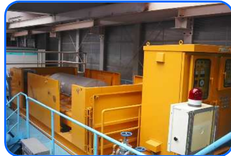
■ 泥水処理設備 (濃縮デカンター)
