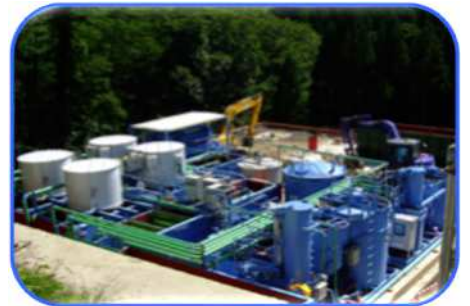
■ 濁水プラント
